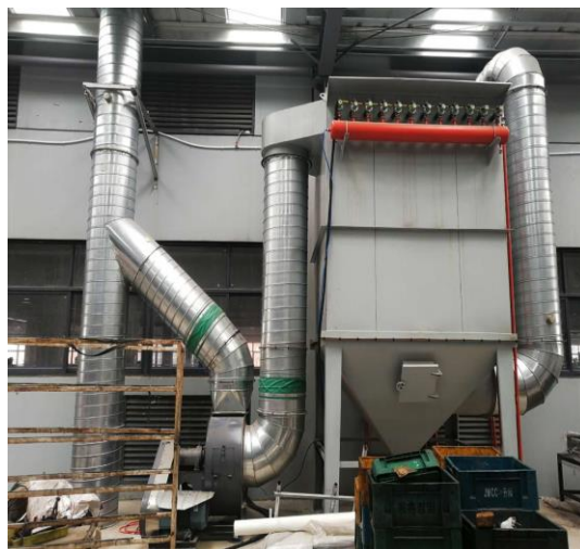
布袋除尘器及排气筒
