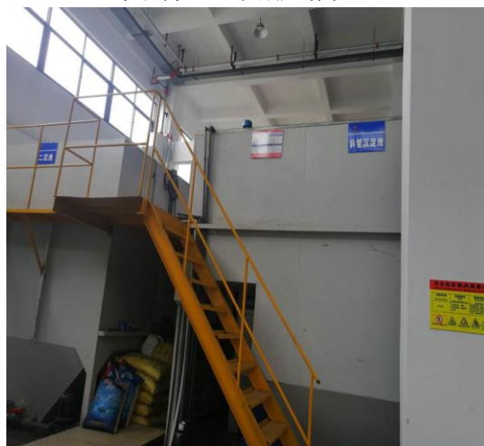
厂区污水处理站
